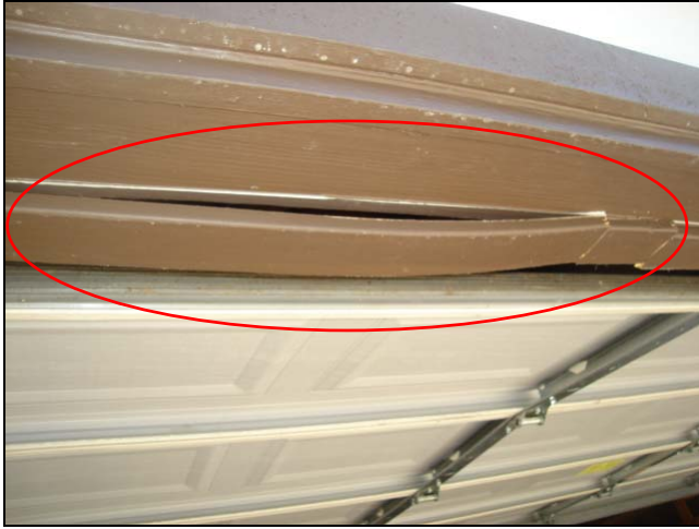
Loose big door trim.
