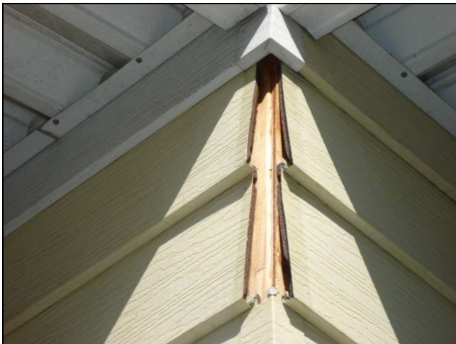
Missing corner metal trim.
