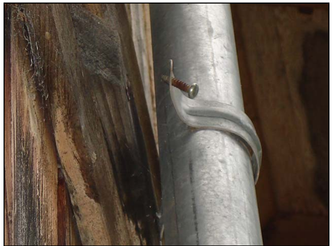
Loose mast pipe clamp.
