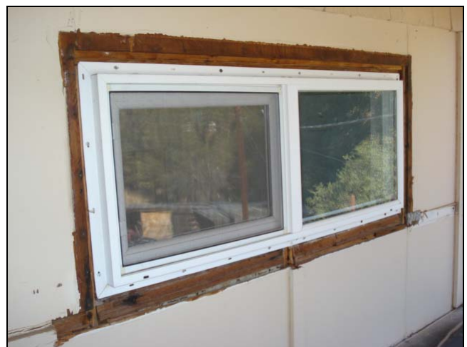
Missing window trim.
